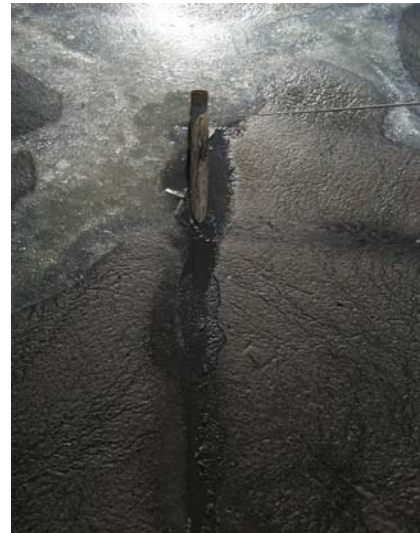
Abbildung 22: Abzugsrohr in der Position zum Trübwasserabzug
