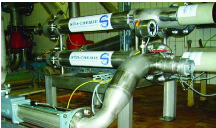
Abbildung 35: Desintegrationsanlage mit Exzentrerschneckenpumpe [58]
